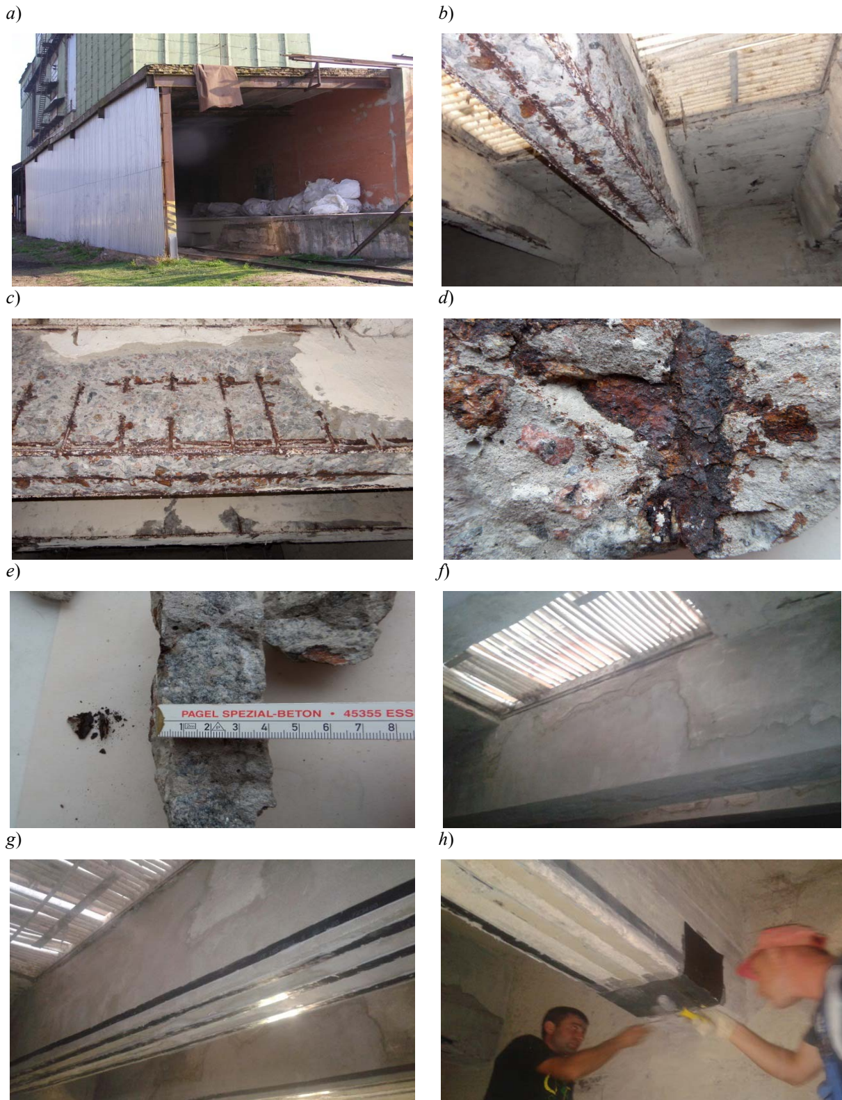
Рис. 1. Посилення залізобетонних балок пошкоджених корозією: a – загальний вигляд вузла; b, c – стан несучих балок в часі обстеження; d, e – відколотих зразків бетону; f – загальний вигляд відновленої несучої залізобетонної балки; g – посилення відновленої залізобетонної балки вуглецевими стрічками; h – анкерування елементів посилення вуглецевих стрічок
