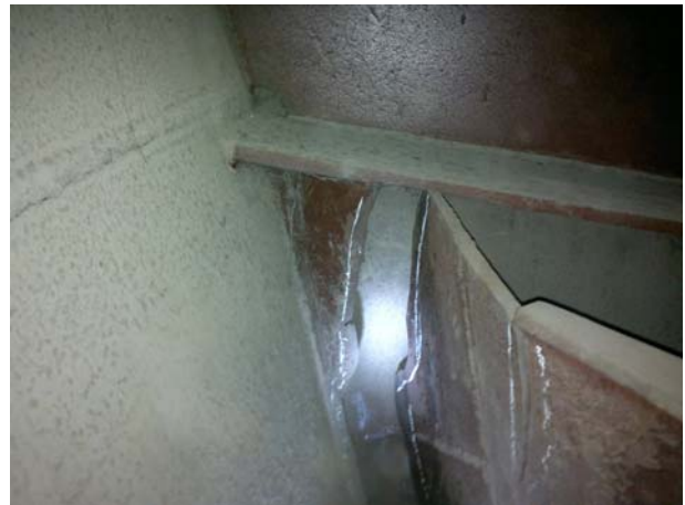
Рис. 5. Обрыв тяги в зоне её примыкания к боковой стенке главной балки со стороны нижнего бьефа
