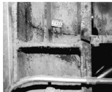
Рис. 2. Розрив колони при зварному з'єднанні ригель-колона після землетрусу
