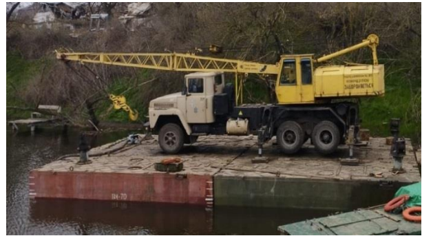
Рис. 8. ПМ-70 під час відновлення мосту через р. Інгулець Бериславського р-ну Херсонської обл.
