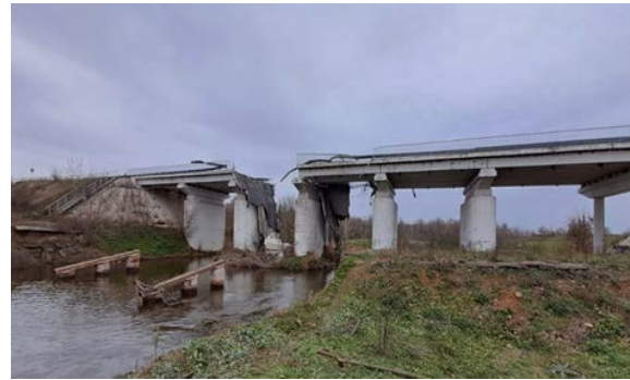
Рис. 6. Характер руйнувань мосту
