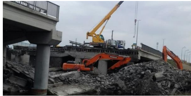
Рис. 2. Зруйновані плити ПБ 3-4 та ПБ 4-5
