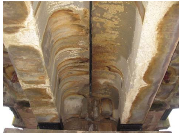
Рис. 2. Іржаві патьоки на внутрішній поверхні плити баластового корита та ребер залізобетонних прогонових будов
