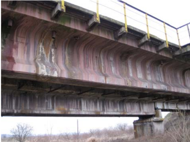
Рис. 4. Зміна забарвлення бетоном по усій поверхні залізобетонної прогонової будови
