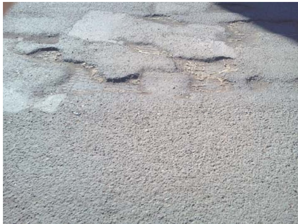
Рис. 1. Разрушение асфальтобетонного покрытия и армирующей геосетки из стекловолокна
