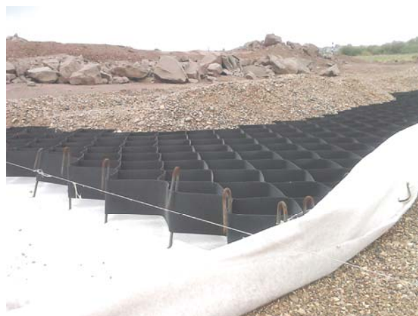
Рис. 2. Армирование верхнего слоя слабого основания геосотами с разделяющей прослойкой из иглопробивного материала и анкерровкой в подстилающем выравнивающем слое из ПГС
