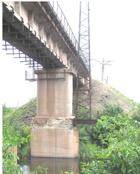
Рис. 3. Металева обойма і консоль під опору контактної мережі
