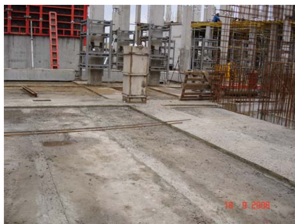
Рис. 8. Сборно-монолитное перекрытие из сборных многопустотных плит настила и монолитных несущих и связующих ригелей
