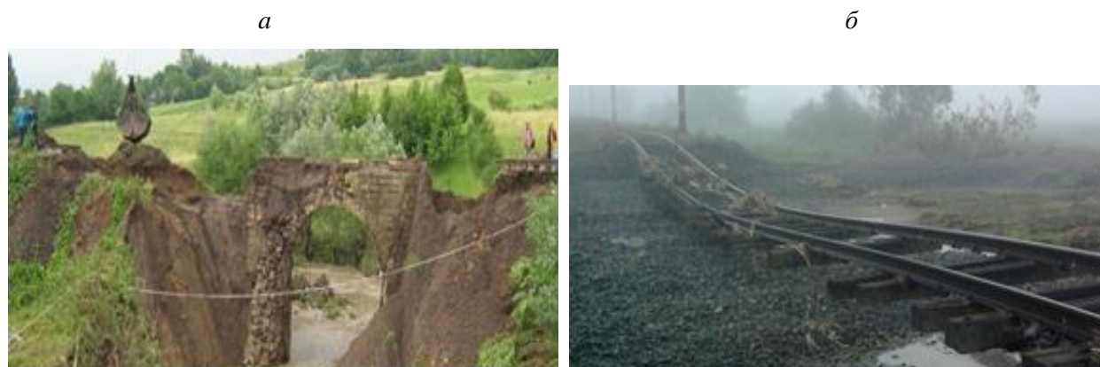
Рис. 3. Дефекти споруд в експлуатації: а) руйнування кам'яного аркового моста; б) розмив насипу залізничної колії під час паводку
