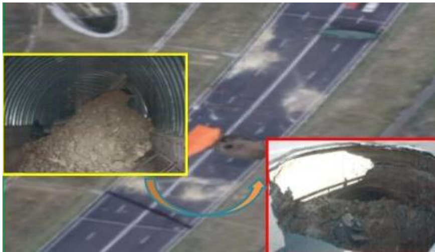
Рис. 8. Обвалення дороги над металевою гофрованою конструкцією на км 1+350 ділянки автомобільної дороги Сімферополь – Євпаторія – Мирне – Дубки
