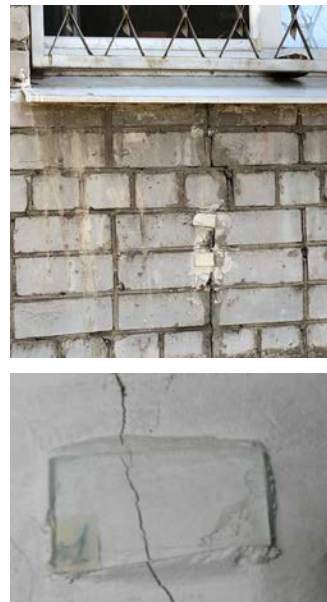
Рис. 4. Тріщина в гіпсових маячках, встановлених на зовнішній і внутрішній несучих стінах
