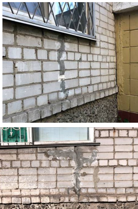
Рис. 10. Гіпсові маячки, відновлені на зовнішніх несучих стінах після посилення пальових фундаментів будівлі (нові тріщини в них не утворились)
