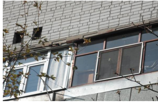
Рис. 3. Обрив верхнього металевого тяжа в рівні перекриття п'ятого поверху
