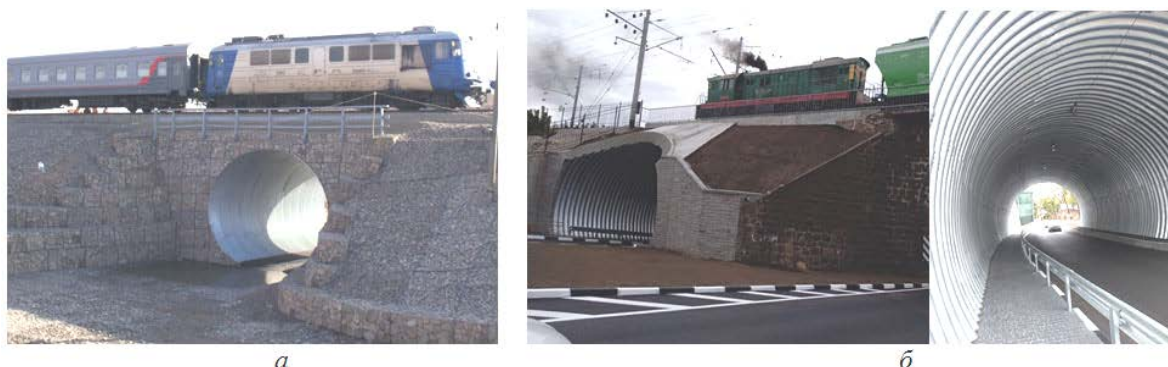
Рис. 2. Транспортні споруди із металевих гофрованих конструкцій на залізницях України: а – металева гофрована труба на ділянці Вадул-Сирет – Держкордон Львівської залізниці та б – тунельний шляхопровід у м. Кропивницькому
