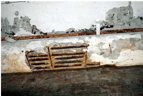
Рис. 1. Корозія арматури балки монолітного перекриття
